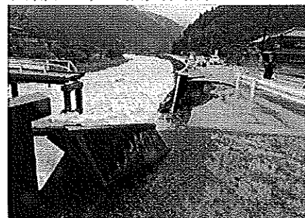
台風12号により流出した橋梁(神河町岩屋)
